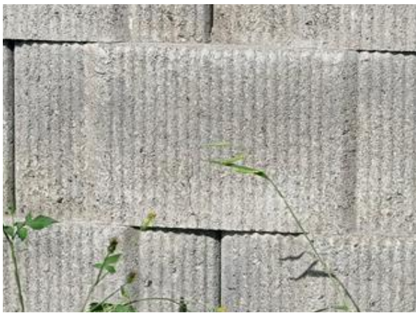
S4 블록 균열(2EA)
